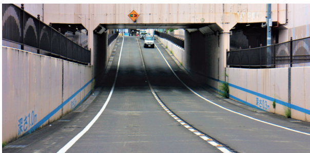
壁面の冠水標示
