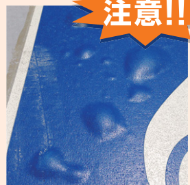
シートに膨らみが発生した例
